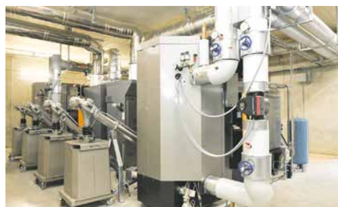
Holzenergiewerke, hier ein Projekt der Holz Energie Regio AG, können in Zukunft eine wichtige Rolle im Zuge der Wärmewende spielen. Foto: DJD/Bundesverband Bioenergie/Andreas Zilse
