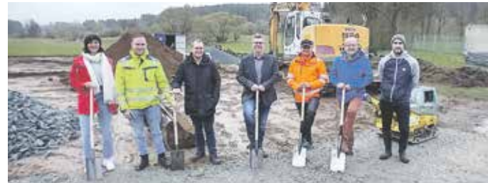
Egerradweg Rös-lau Neudes: v.l.n.r.: Sabrina Kaestner (1. Bürgermeisterin Markt-leuthen), Kevin Schaborak (SIGMA Ingenieure), Christian Pöhl-mann (Ingenieurbüro für Tiefbautechnik), Heiko Tröger (1. Bürgermeister Rös-lau), Thomas Schädlich (VSTR AG), Franz Moder (OPUS - Umwelt-baubegleitung), Andreas Grimm (OPUS - Umweltbaubegleitung)
